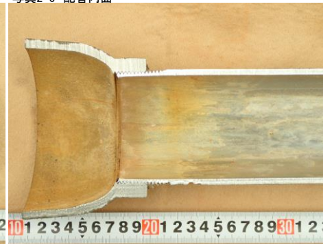
写真2-7 配管内面 拡大
