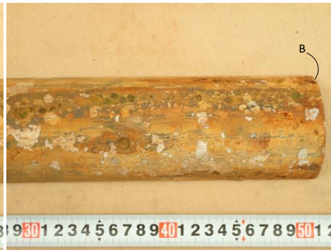
写真2-3 配管外面 拡大
