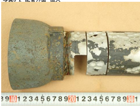
写真3-4 配管外面 拡大
