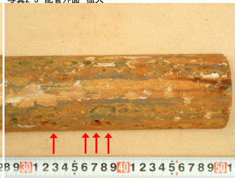
写真2-5 配管外面 拡大
