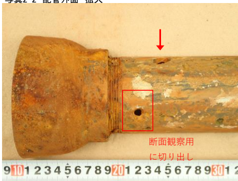
写真2-4 配管外面 拡大
