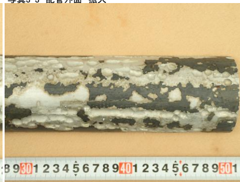
写真3-5 配管外面 拡大
