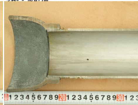
写真3-7 配管内面 拡大
