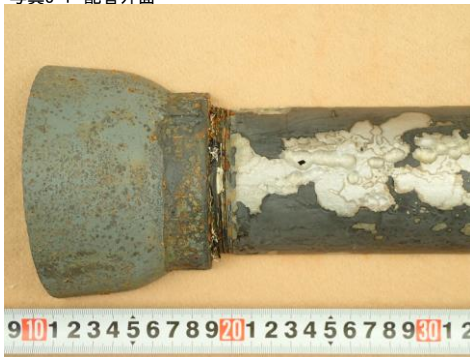
写真3-2 配管外面 拡大
