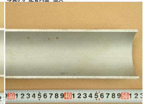
写真3-10 配管内面 拡大
