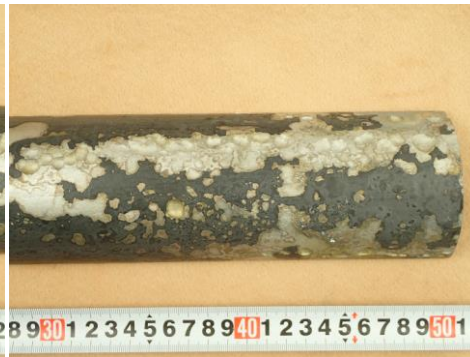
写真3-3 配管外面 拡大
